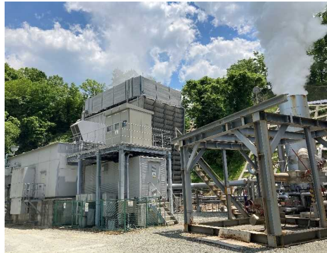
隣地にて稼働中の地熱発電所1号機
