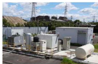
水素供給設備例
